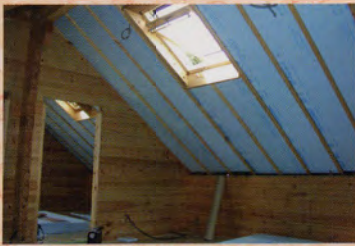
2003年6月 断熱材 特に夏場は天井が熱くなるので断熱材は2重に貼った。
