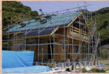
2003年5月 屋根工事 業者に依頼。ログ組みが遅くなると雨などで部材にカビが生えるので、屋根工事までは早く終わらせた
